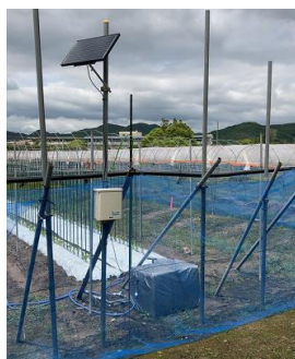
電源用ソーラーパネルと基盤
