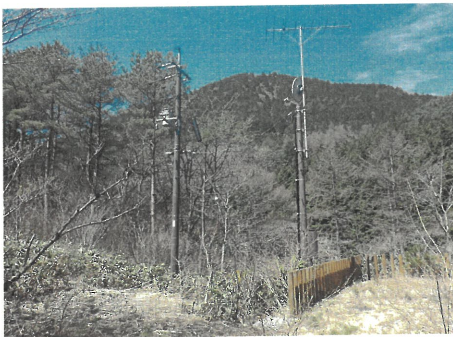
⑬ 電気施設
