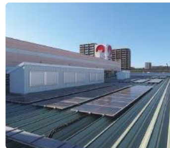
太陽光発電システム
