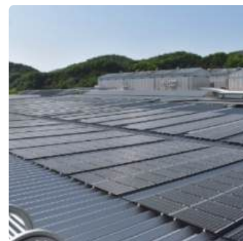
太陽光発電設備
