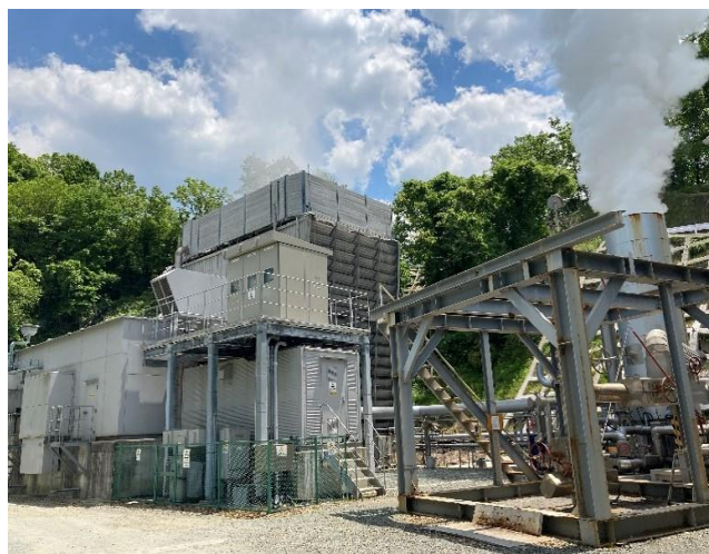
隣地にて稼働中の地熱発電所1号機
