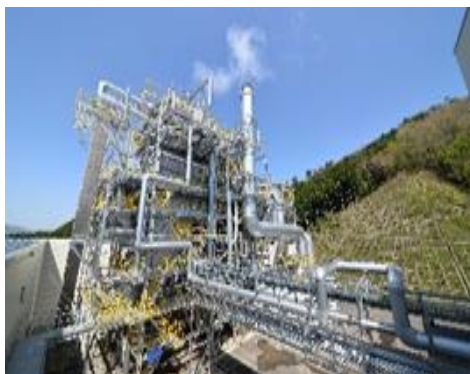
既存の木質バイオマス発電所
