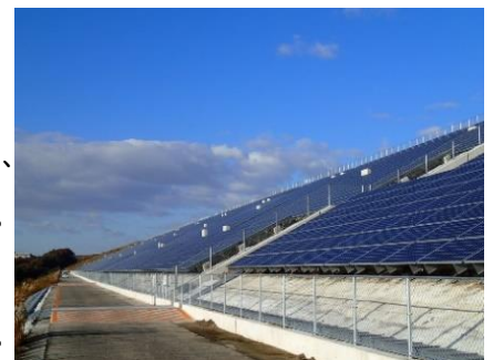
写真：岡山空港太陽光発電所
