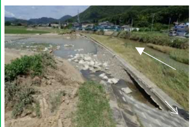
高梁川水系尾坂川 笠岡市 決壊：左岸L=80m 浸水面積：約102ha 浸水戸数：約207戸
