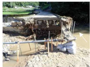
芦田川水系高屋川 井原市 決壊：左岸L=35m 浸水面積：約2ha 浸水戸数：なし
