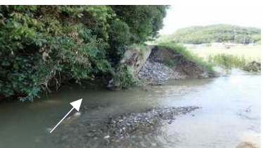
高梁川水系岩倉川 井原市 決壊：右岸L=15m 浸水面積：約8ha 浸水戸数：なし
