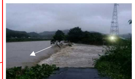
旭川水系砂川 岡山市 決壊：左岸L=120m 浸水面積：約752ha 浸水戸数：約2,246戸
