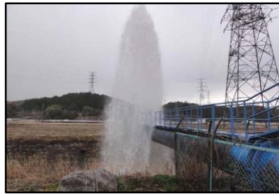
水管橋空気弁からの漏水(福島県)
