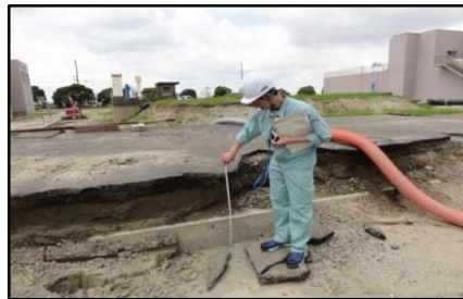
共同溝の不同沈下(茨城県)
