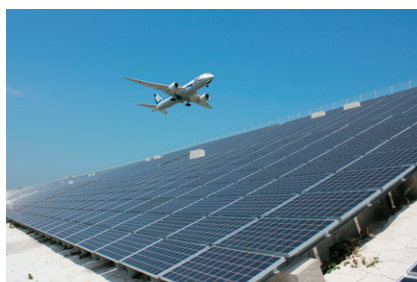
岡山空港太陽光発電所
