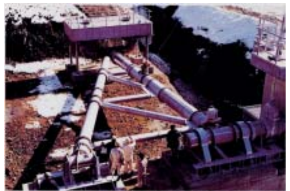
フローティングアーム 写真上部の四角い部分が水に浮き、そこから水をとる
