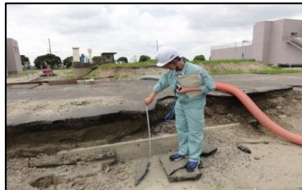
共同溝の不同沈下(茨城県)
