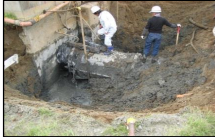
構造物接続部の配管離脱状況(茨城県)
