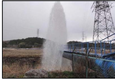
水管橋空気弁からの漏水(福島県)
