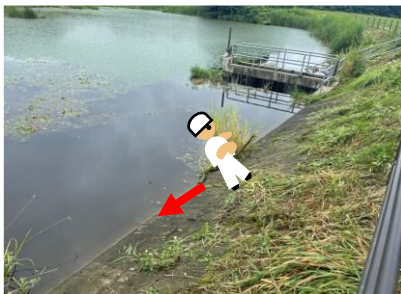
(ため池堤体の急傾斜)
