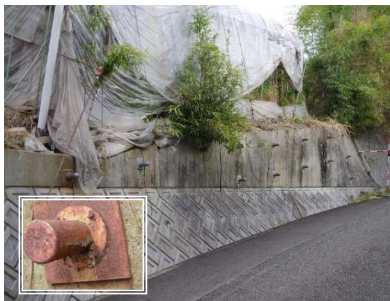
アンカー工：頭部キャップ腐食
