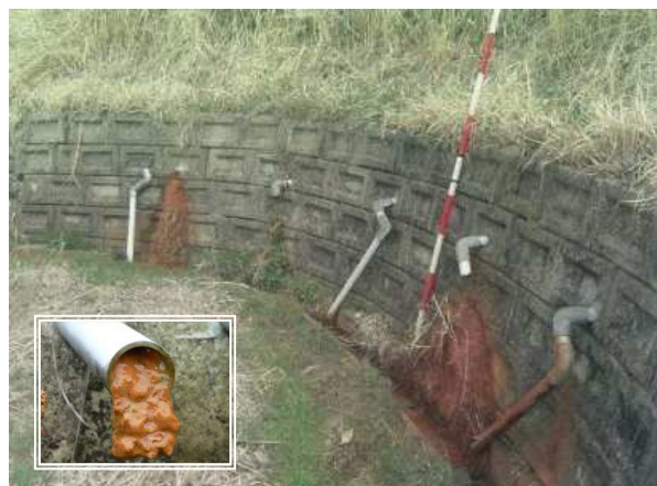
排水ボーリング：孔内閉塞
