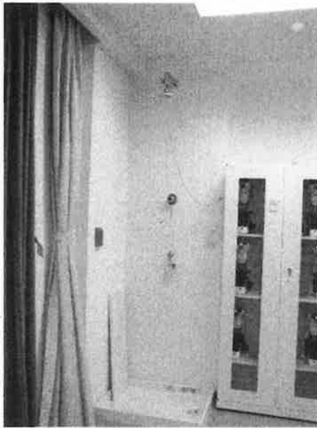
▲設備（実験室 シャワー）
