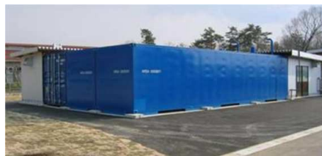
メタン発酵槽
