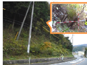
【⑤落石危険】 国道 181号(真庭市)
