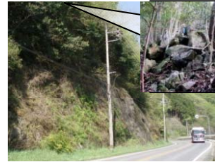
【⑤落石危険】 国道 180号(新見市)
