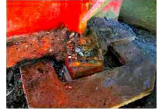
【⑥橋梁老朽化】 国道 482号(中戸橋・真庭市)
