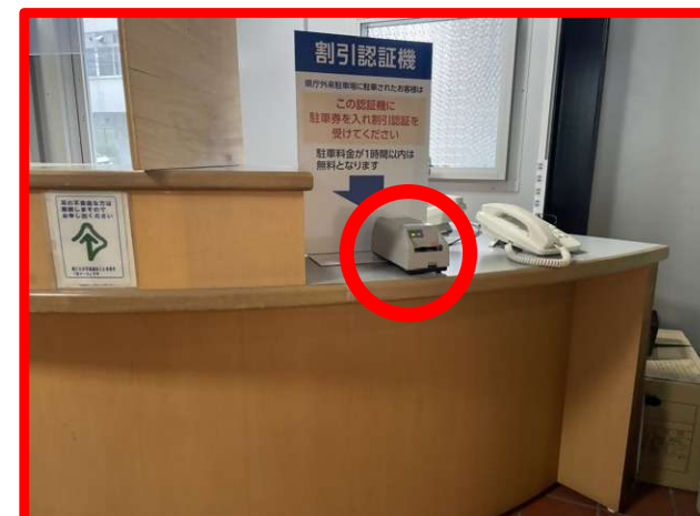
割引認証機② (西庁舎出入口守衛)
