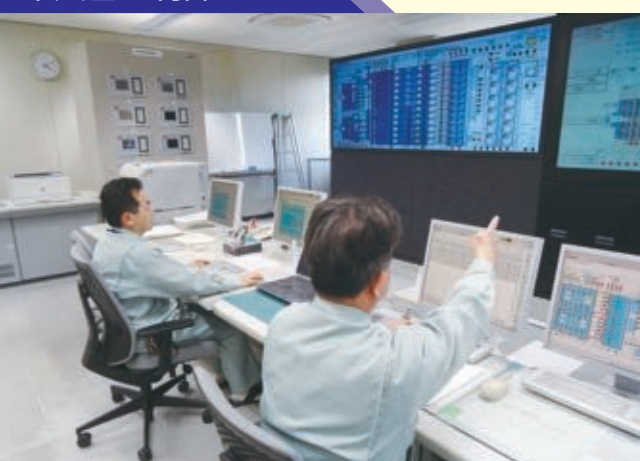
中央管理制御室
