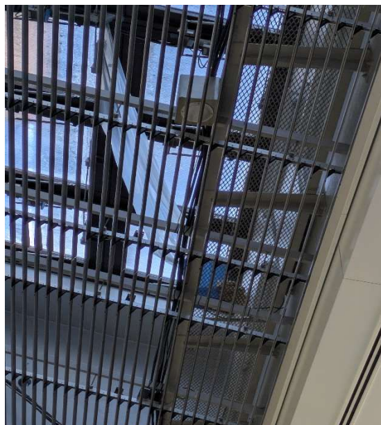
国際線上部(水漏れ状況)
