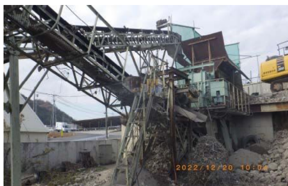
産業廃棄物処理施設（がれき類の破碎施設）
