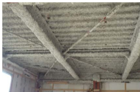
(アスベストが吹き付けられた天井)
