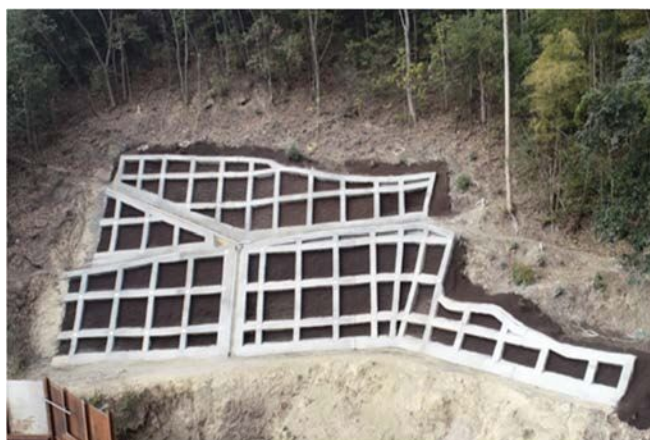
急傾斜地崩壊危険区域 銀山西地区
