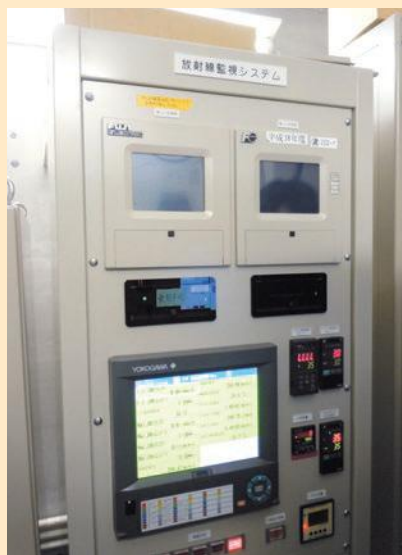
空間ガンマ線測定装置
