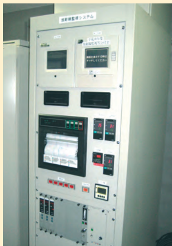
空間ガンマ線測定装置
