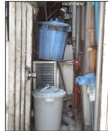
吹き出し口が塞がった室外機
