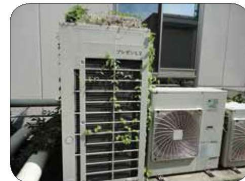
草で覆われた室外機
