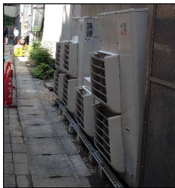
倒れそうな室外機
