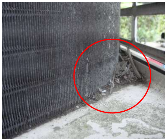
⑧ 空冷凝縮器
