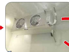
冷凍冷蔵庫の冷却器
