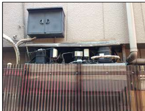
雨ざらしの室外機
