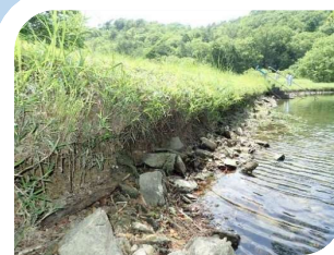
上流法面が侵食されている状態
