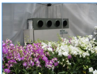
安定的採熱と ヒートポンプ利活用
