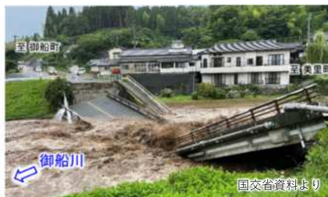
令和5年の豪雨で、御船川（熊本県）に架かる橋が倒壊し、流水を阻害している様子
