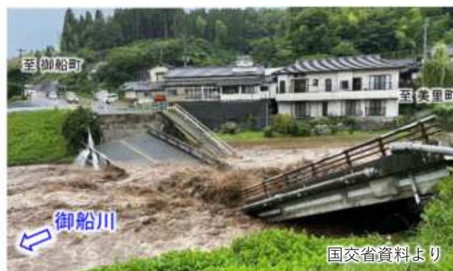
令和5年の豪雨で、御船川（熊本県）に架かる橋が倒壊し、流水を阻害している様子
