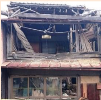
対象：老朽危険空き家
