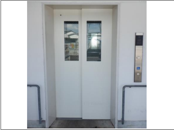
エレベーター
