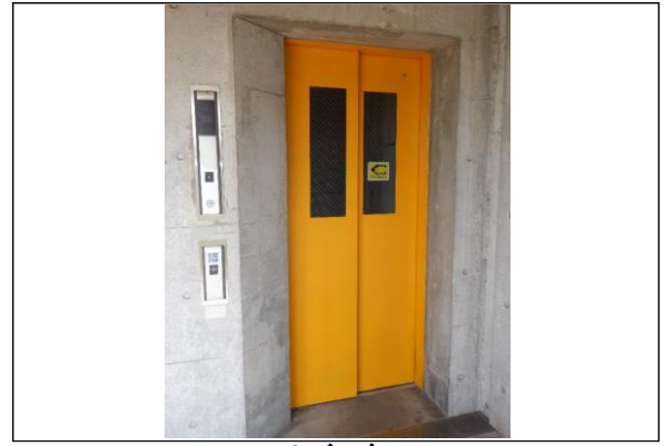
エレベーター
