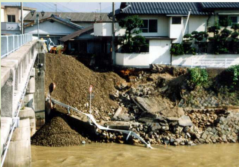
増水した川の水で削られ、崩れた道
