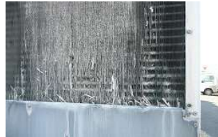
例) 室外機の腐食
