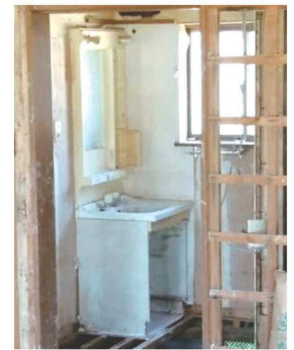
浸水後の洗面台
