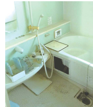
浸水したユニットバス
