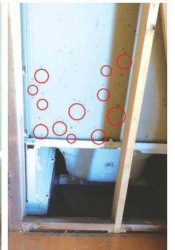
裏側に発生したカビ
