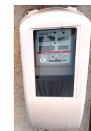
電気メーター
