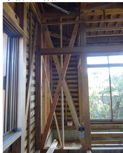
④新設筋交い
