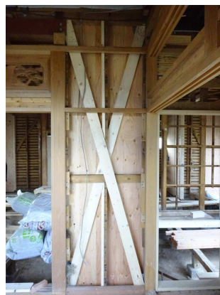
④新設筋交い
