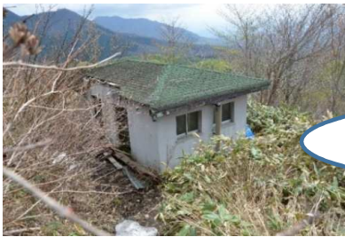
老朽化した施設
