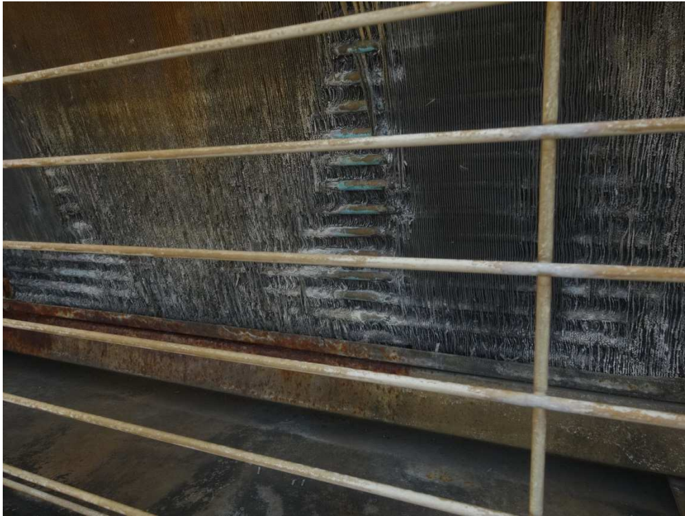
散水による室外機の劣化の事例
