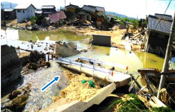
被災時状況 (H30.7.10)
