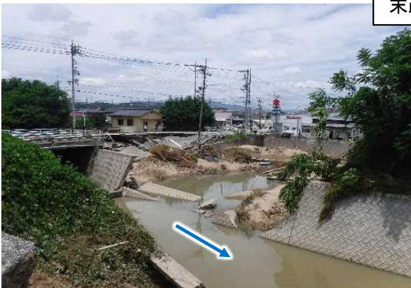
被災時状況 (H30.7.10)
