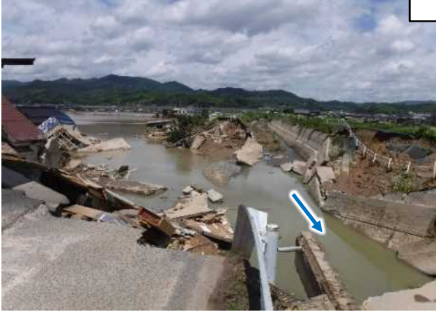
被災時状況 (H30.7.9 撮影)
