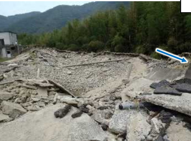
被災時状況 (H30.7.11 撮影)
