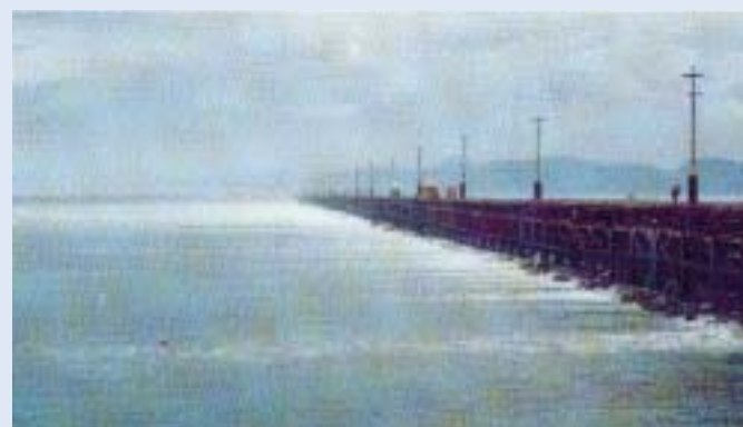
堤防の工事中は、海の干満によって捨て石の間から 海水が流れ込むこともありました
