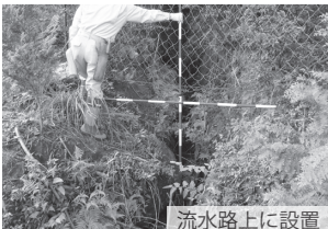
流水路上に設置
