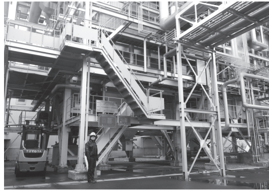
真庭バイオマス発電所
