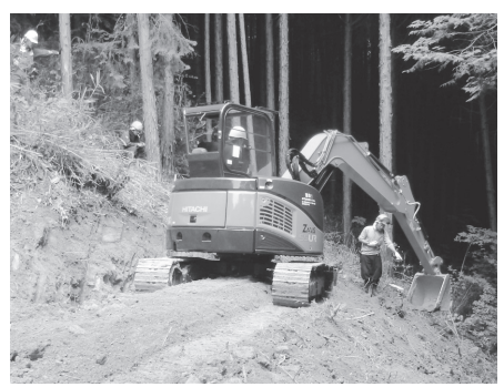
5t級のバックホウを使用し、作業工程を習得しています。
