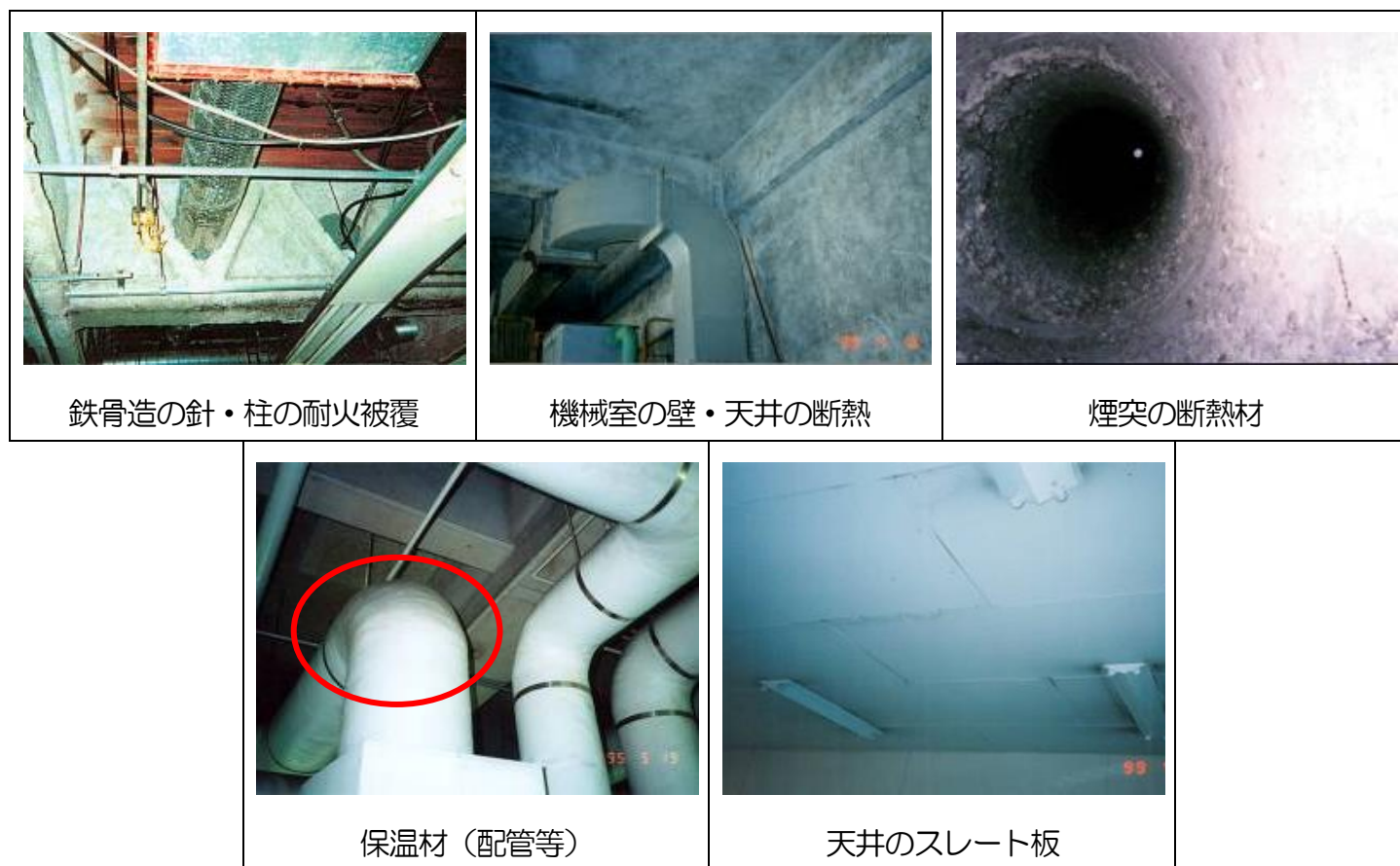
【アスベスト含有建材の例】
