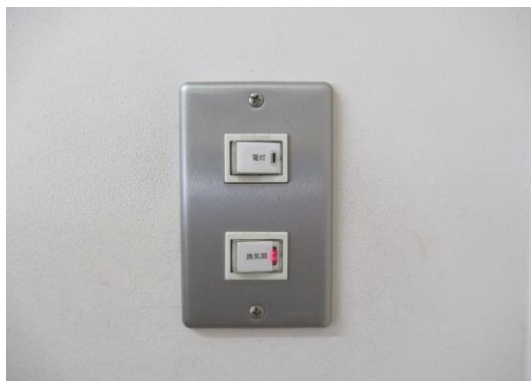
【(改修前) スイッチ】
