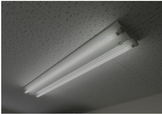
【(改修前) 蛍光灯】
