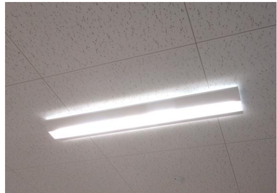
【(改修後)LED照明(スクールコンフォート)】
