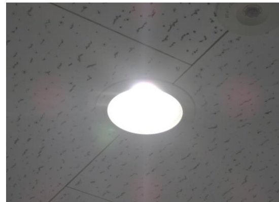
【(改修後) LED照明(ダウンライト)】
