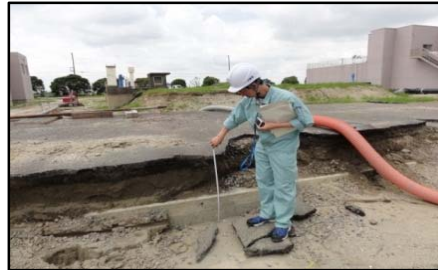
共同溝の不同沈下(茨城県)
