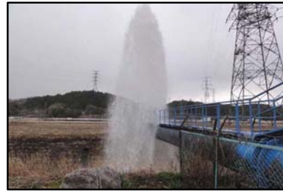
水管橋空気弁からの漏水(福島県)
