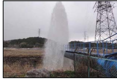
水管橋空気弁からの漏水(福島県)
