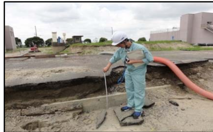
共同溝の不同沈下(茨城県)
