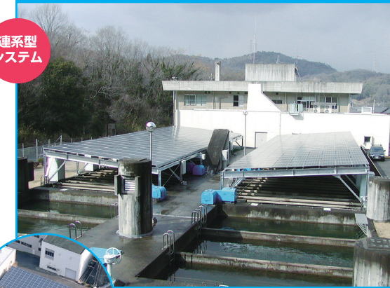
笠岡浄水場 所在地：笠岡市金浦454 ●出力：70kW
