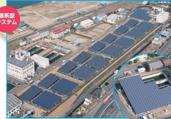
西之浦浄水場 所在地：倉敷市連島町西之浦5912-3 ●出力：800kW
