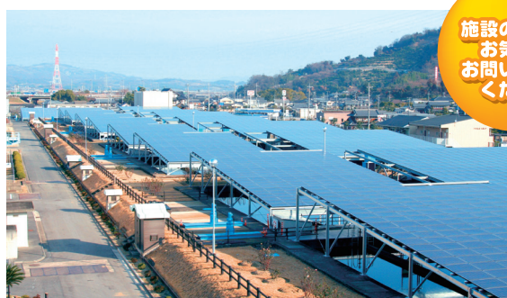
工業用水道事務所(西之浦浄水場)太陽光発電システム
