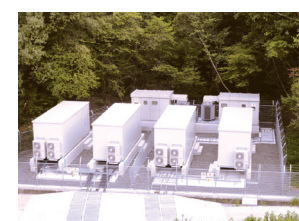
パワーコンディショナ (岡山空港太陽光発電所)
