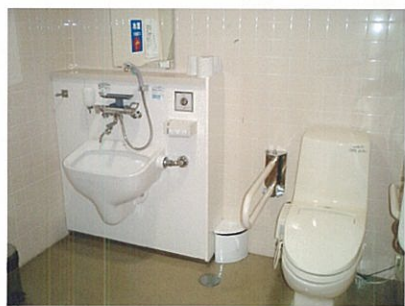
車いす使用可能な広めの多目的トイレ オストメイト対応
