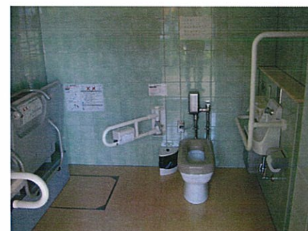
車椅子用トイレは障害に応じて二種類のトイレを 用意している。このトイレは大人も利用できる多 目的シートとベビーチェアを設置している。
