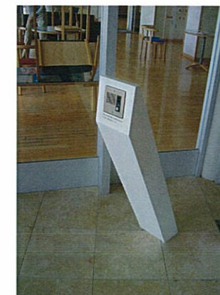
車椅子で利用しやすいように配慮されたインターホン。
