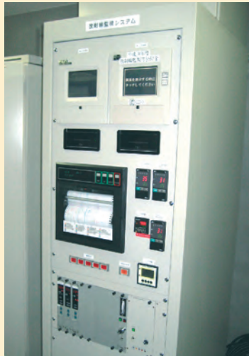
空間ガンマ線測定装置
